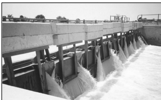
شکل ۲- نمایی از دریچه آویخته در شبکه‌های آبیاری
