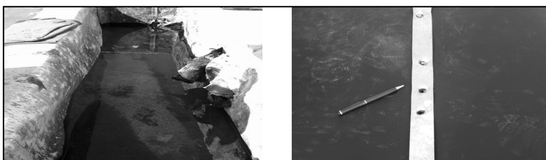
شکل ۳- کیفیت نامناسب اتصال میخ‌های فولادی و جدا شدن پوشش اضافی اجرا شده در ورودی کف استخر.
