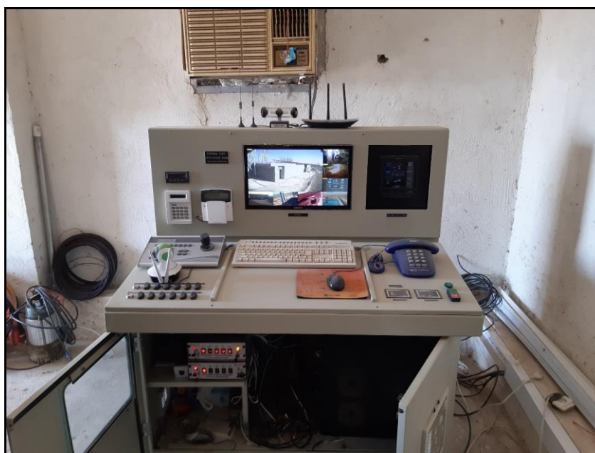
شکل ۹- سامانه آبیاری تجهیز شده به سامانه اسکادا (آبیک- قزوین) Fig. 9- Irrigation system equipped with SCADA system (Abyek-Qazvin)
