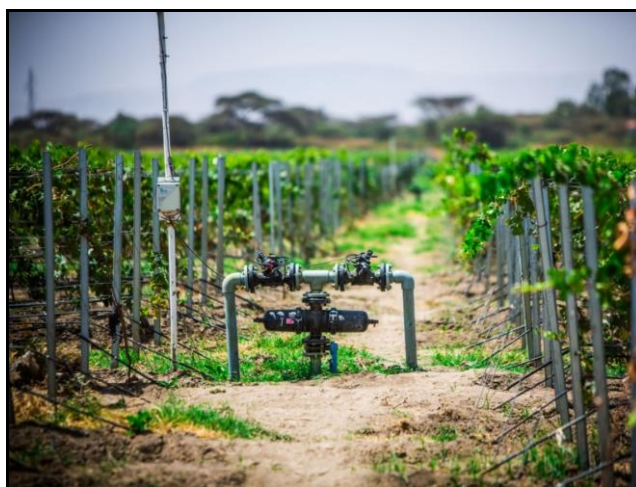
شکل ۸- سامانه آبیاری قطره‌ای تجهیز شده به سیستم اسکادا (لائوس)
