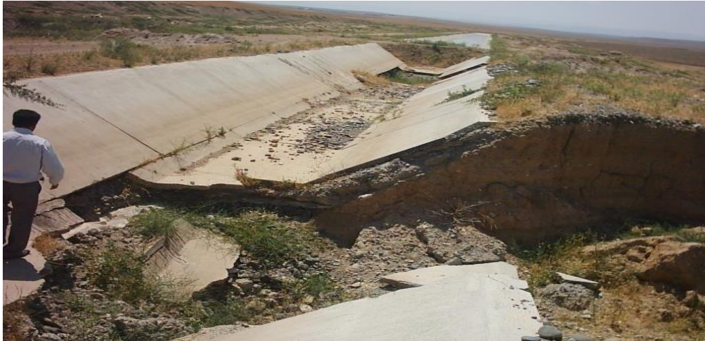
شکل ۲- نمایی از شدت تخریب کانال پمپاژ ۳ در زمان بهره برداری Fig. 2- A view of the destruction of pumping channel 3 during operation.
