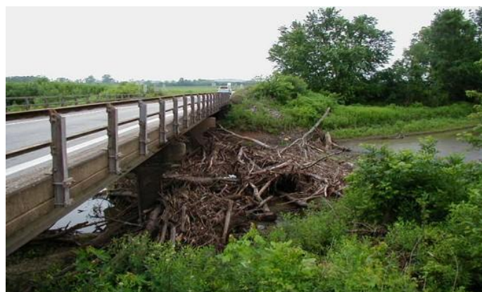
شکل ۱- انسداد دهانه پل توسط واریزه‌های چوبی
