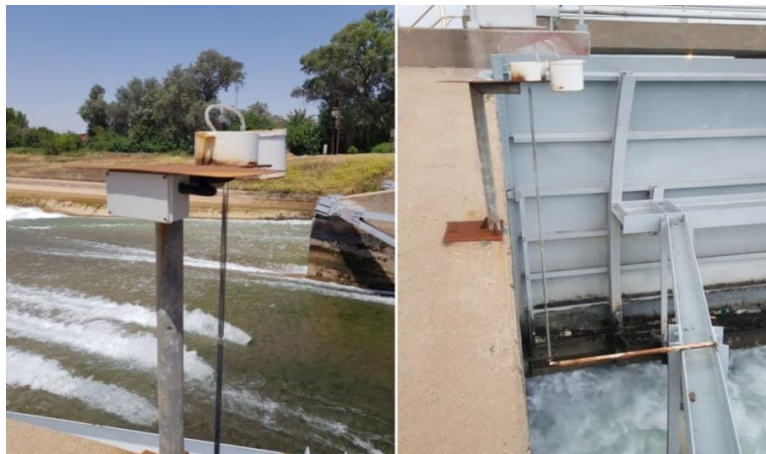
شکل ۱۶- نصب حسگر VIGIGATE برای سنجش خودکار گشودگی دریچه‌های ورودی کانال W1
