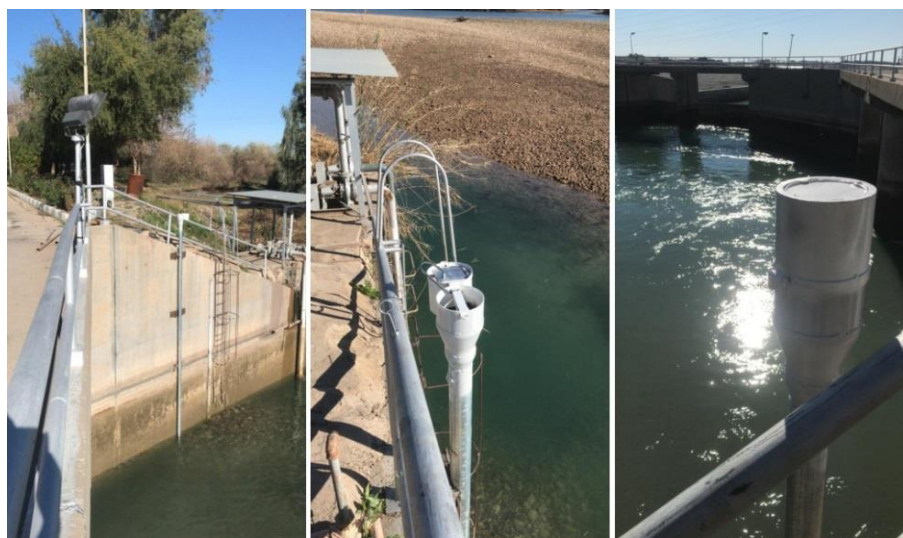
شکل ۱۲- نصب سطح سنج ثابت VIGILEVEL در بالادست دریچه‌های ورودی کانال W1
