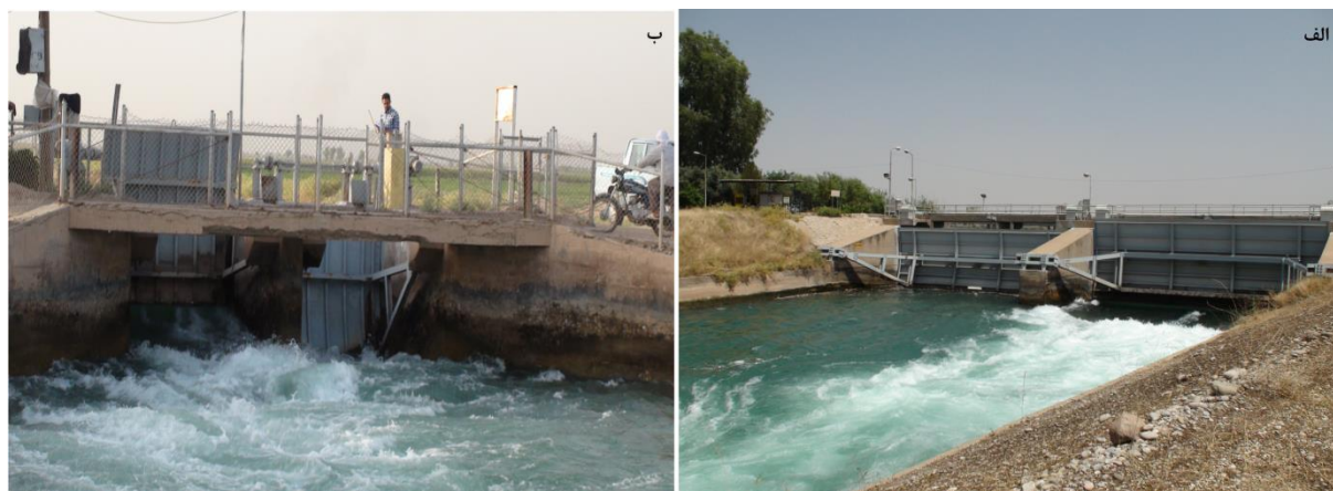
شکل ۲- (الف) دریچه‌های قطاعی ورودی کانال اصلی غرب دز (دریچه راست باز و دریچه چپ بسته) و (ب) دریچه‌های قطاعی در کانال آبیاری فرعی ۳۵ کیلومتری غرب دز (دریچه راست تحت شرایط جریان آزاد و دریچه چپ تحت شرایط آستانه استغراق) Fig. 2- (a) Radial gates at the inlet of the West Dez main canal (right gate is open, left gate is closed) and (b) radial gates in the West Dez 35-km secondary irrigation canal (right gate under free-flow conditions, left gate under transition flow conditions)
