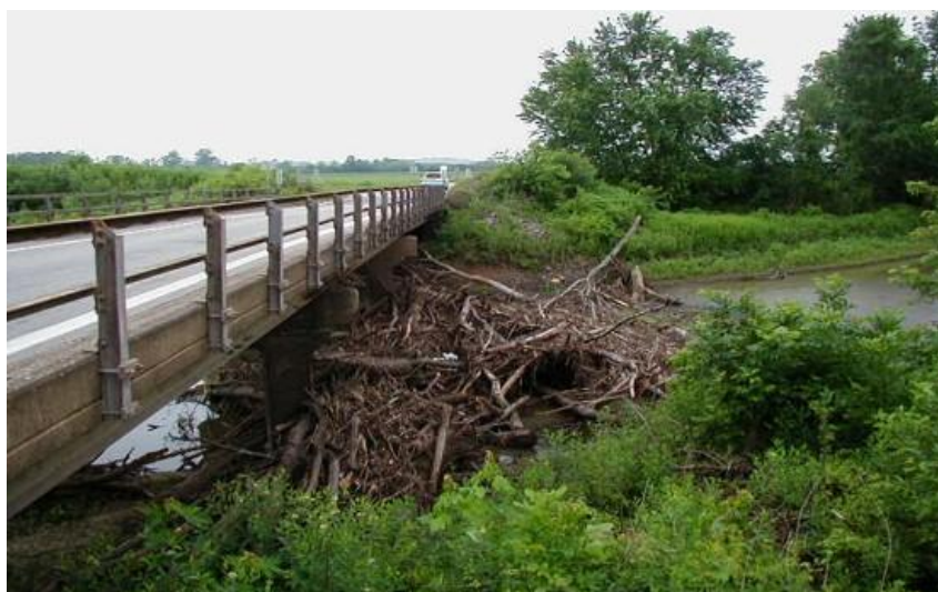
شکل ۱- انسداد دهانه پل توسط واریزه‌های چوبی
